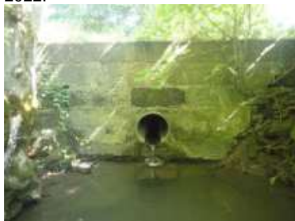
Rohnsbach. Fehlende Durchlässigkeit. (auch für Landlebewesen), fehlendes Sohlsubstrat. Quelle: Büro am Fluss 2022.
