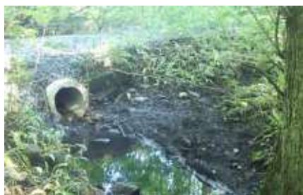
Absturz am Dachbach. Verrohrung ohne Sohlsubstrat. Quelle: Büro am Fluss 2022.
