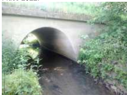
Durchlass Massenbach – ohne seitliche terrestrische Bermen, die Landlebewesen ein Unterqueren der Brücke „trockenen Fusses“ ermöglichen würden. Fehlende Durchlässigkeit. Quelle: Büro am Fluss 2022.
